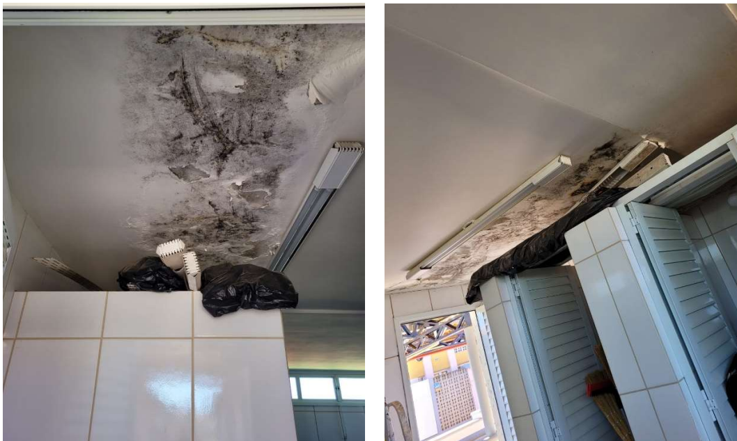
Manifestação patológica localizada na parte interna do forro da edificação.
